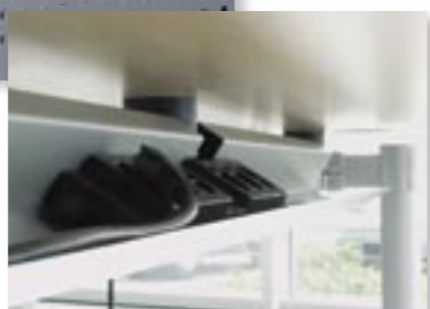
Großvolumiger horizontaler Kabelkanal
